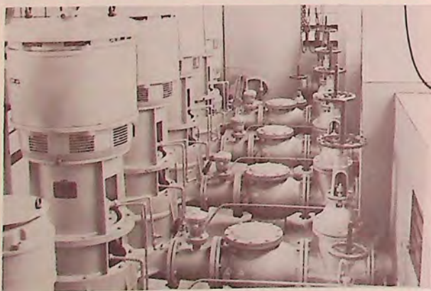
Машинната зала на помпена станция „Сливо поле“
