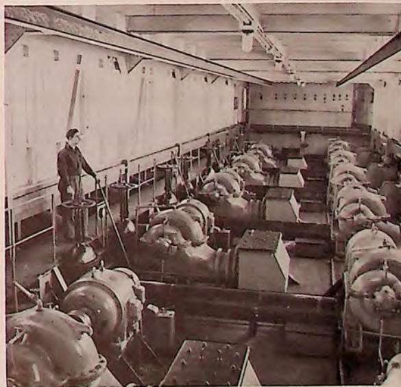
Машинната зала на плаваща помпена станция № 23
